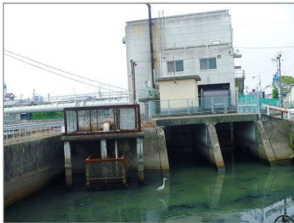
長尾谷川の水をポンプアップして 大きなパイプで海に直接放流。
